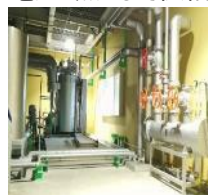
蒸気ボイラー
