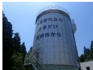
メタン発酵槽
