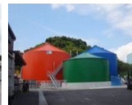
メタン発酵槽・消化液槽
