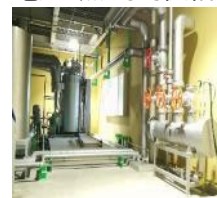
蒸気ボイラー
