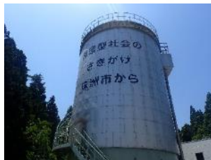
メタン発酵槽
