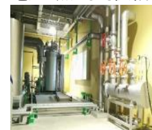
蒸気ボイラー
