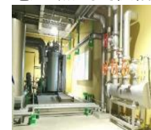
蒸気ボイラー
