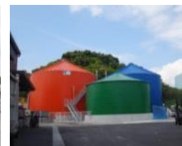
メタン発酵槽・消化液槽
