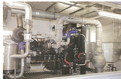
ガスを利用して熱・電気を供給
