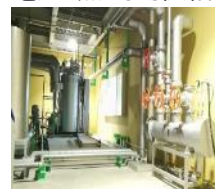
蒸気ボイラー
