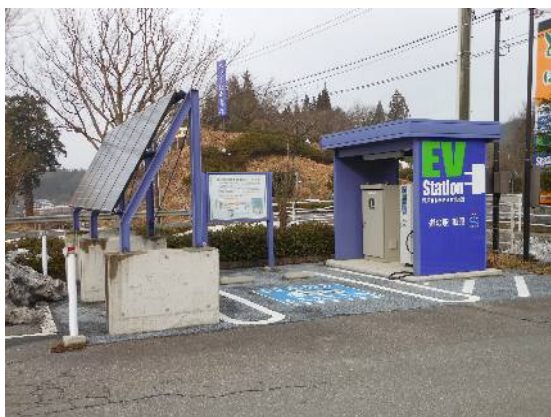
写真6 EVスタンド（道の駅頓原）
