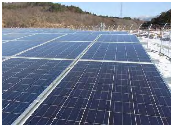
写真① 一関市東山太陽光発電所
