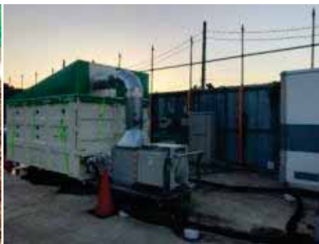
乾燥コンテナ・ 熱回収システム・ ファンユニット
