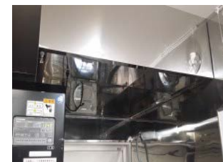
空気換気設備 （調理場）
