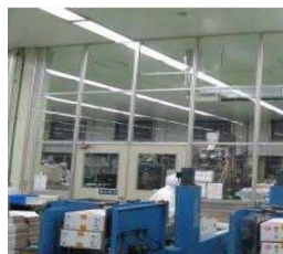
空気を経由した汚染の防止設備 (パーティション)の導入
