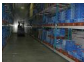
工場に完備された冷蔵設備
