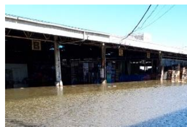
大雨による浸水被害（荷捌場）
