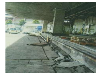
地震による施設被害
