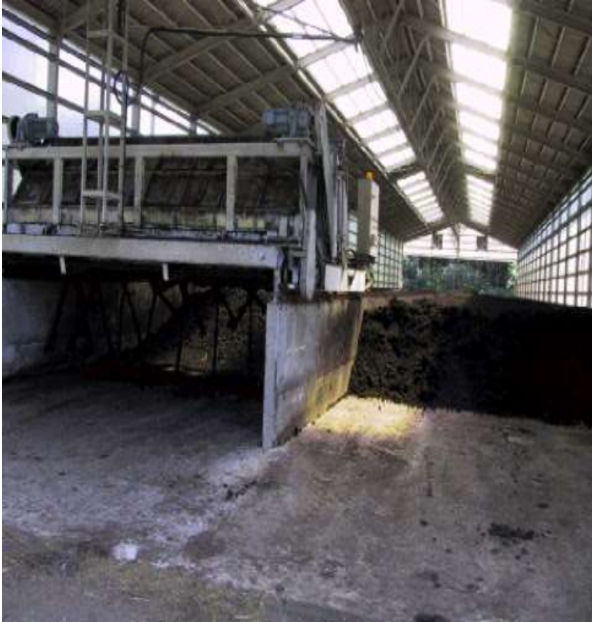
開放式直線型発酵方式 (ロータリー攪拌装置)
