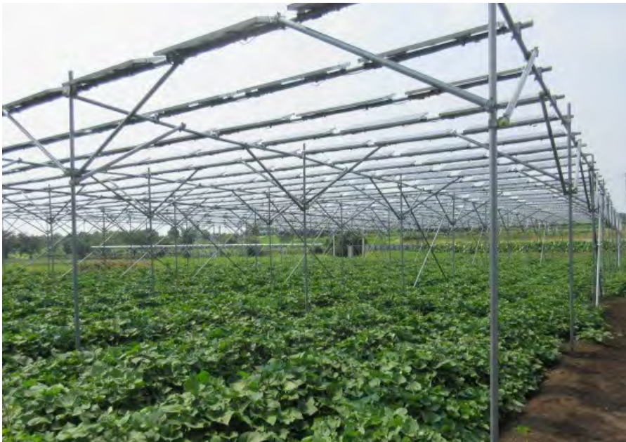
露地の畑の上部にパネルを設置
