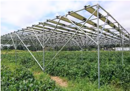
発電設備の外観
