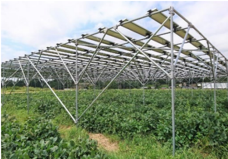
発電設備の外観
