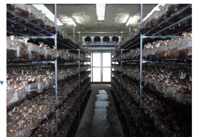
栽培ハウス内部と Fan Coil Unit
