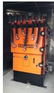
乾燥チップボイラ (施設加熱源)
