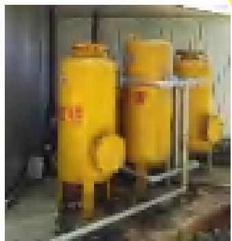
乾式 脱硫装置
