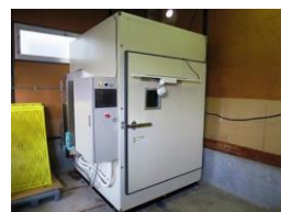
Fig. 2 減圧乾燥設備
