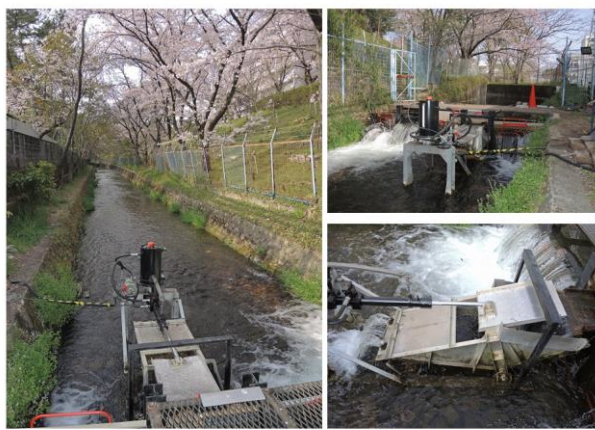
Fig. 1 三角桁式小水力発電装置運用の現場
