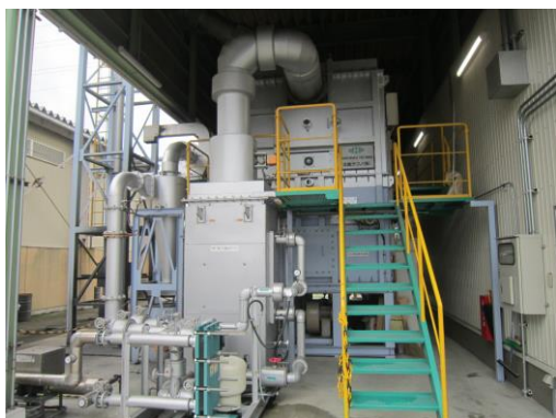
Fig.1 本格稼働したもみ殻循環施設
