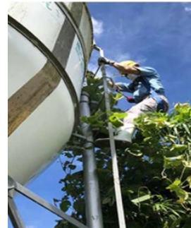
木々が昇降に支障
