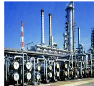
石油プラント
