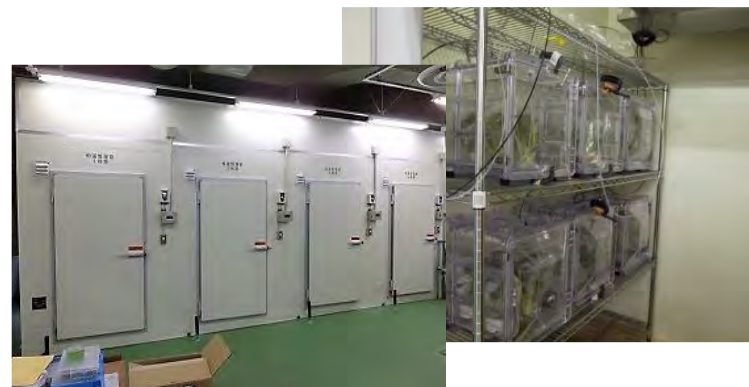
恒温・恒湿・恒ガスコントロール試験室
