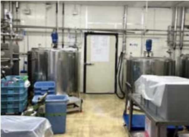
原料貯蔵タンク（左が新設機）
