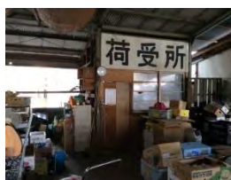
▲老朽化した荷受所
