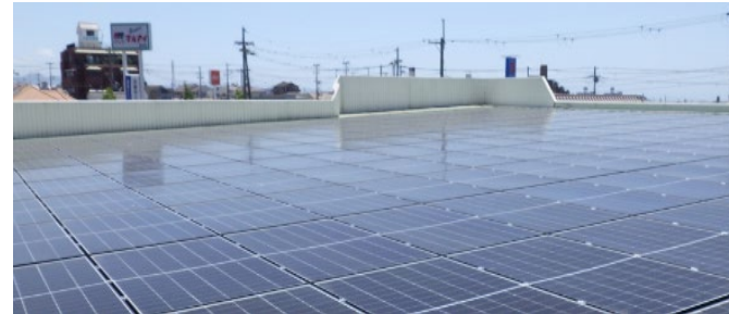
太陽光発電設備
