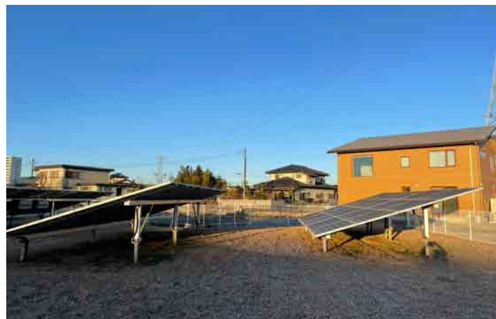
野立てソーラーパネルの設置状況
