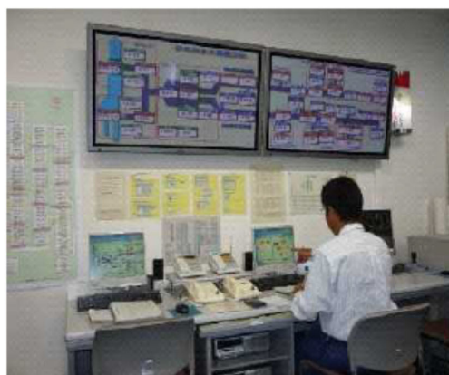
操作室監視状況
