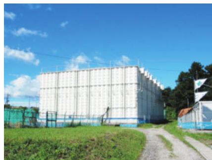
写真 防音ハウス
