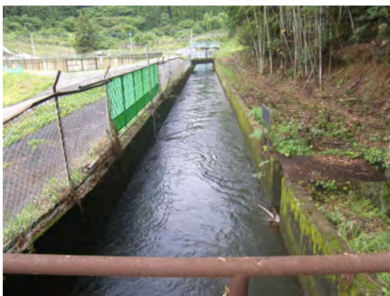
周辺からの落ち葉等のゴミ混入が多く 除塵作業の労力を費やす
