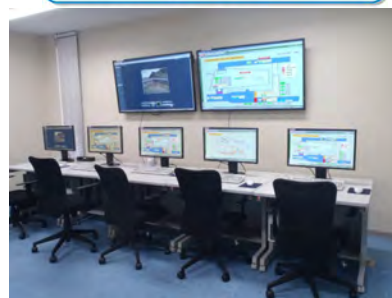
管理所による遠方監視・制御
