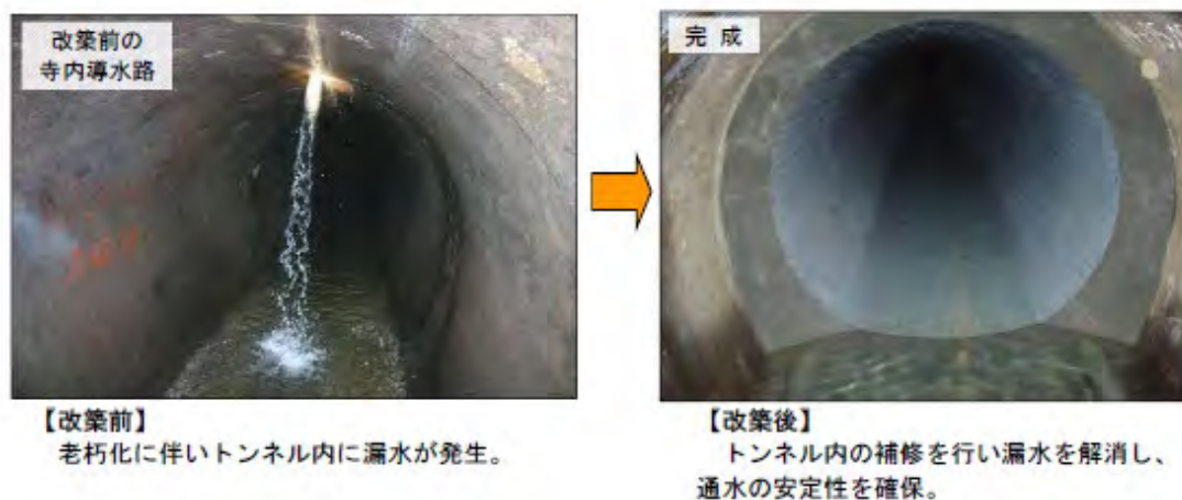
図 寺内導水路老朽化状況及び補修状況
