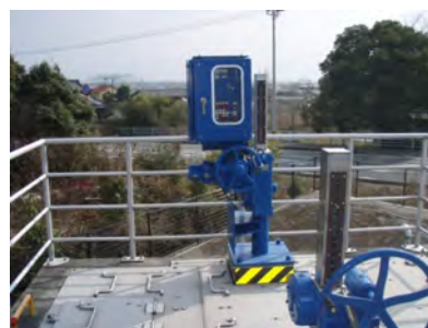
動力による分水工の遠方操作
