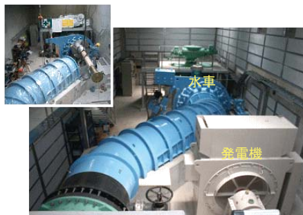
小水力発電施設
