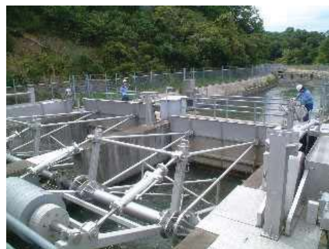
自動水位調節堰点検
