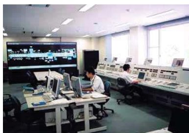
配水管理（総合管理所）
