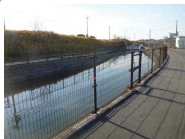
転落防止フェンス
