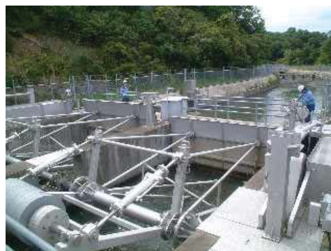
自動水位調節堰点検
