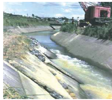
昭和46年台風による開水路の被災状況
