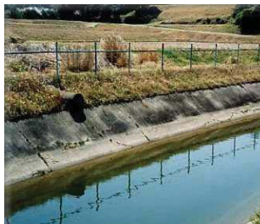
開水路ライニングのひび割れ(クラック)発生状況
