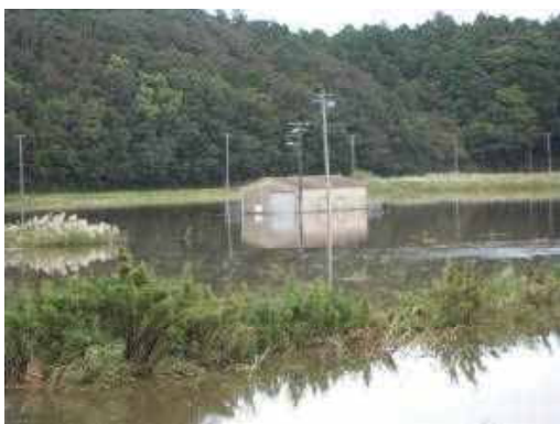
周辺農地の湛水状況
