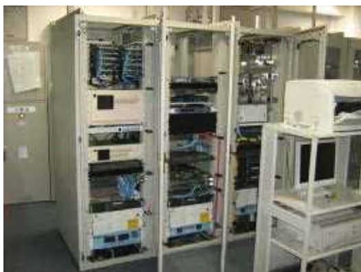
遠方監視制御設備
