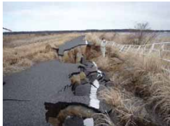
東日本大震災により被災した堤防
