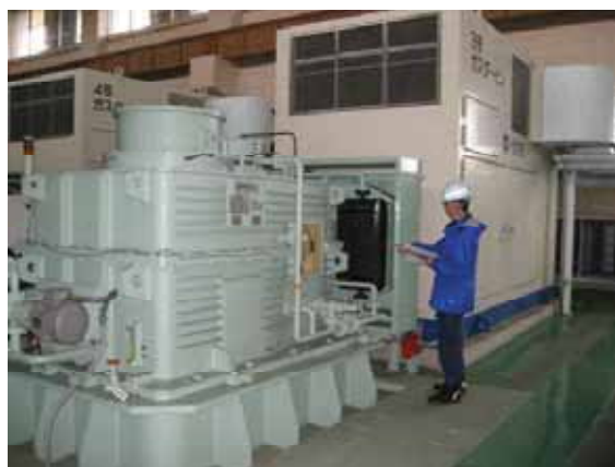
原動機（ガスタービン）の点検
