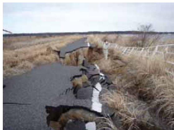
東日本大震災により被災した堤防
