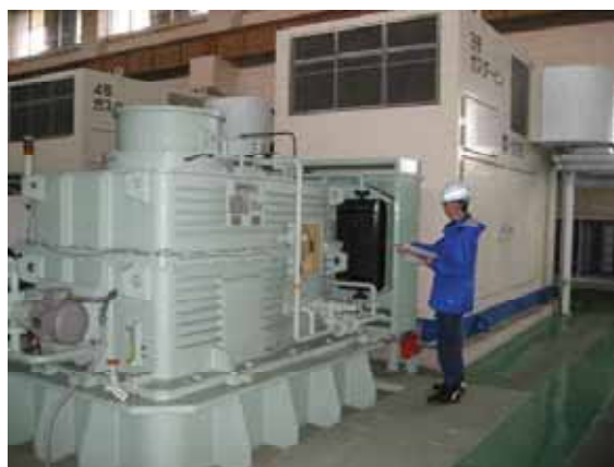
原動機（ガスタービン）の点検
