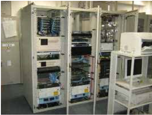
遠方監視制御設備
