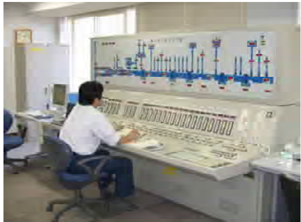
取水、配水の操作及び状態監視
