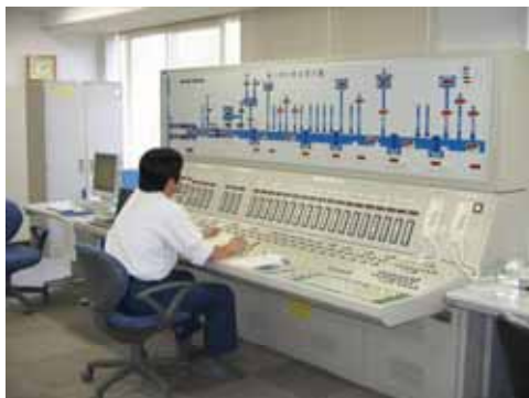
取水、配水の遠隔操作
