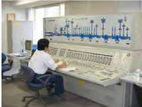
取水、配水の遠隔操作
