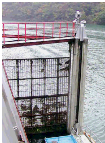
監視カメラ設置
