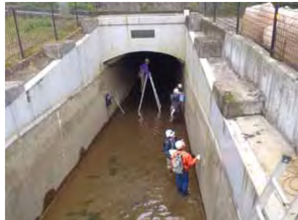
開水路内の劣化調査
