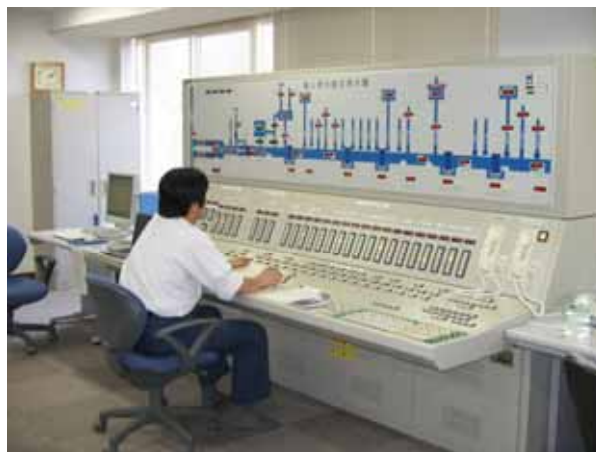
取水、配水の操作及び状態監視
