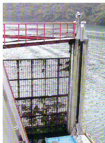
監視カメラ設置
