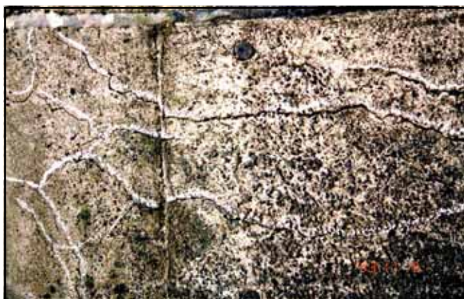
羽間開水路のひび割れ状況
