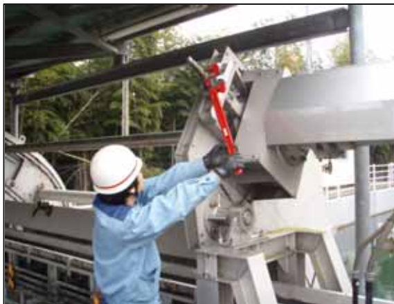
幹線水路除塵機の点検
