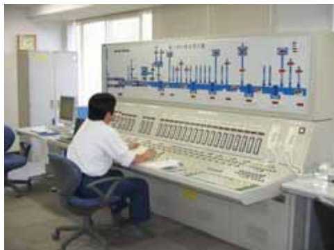
取水、配水の遠隔操作
