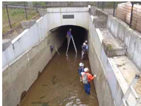
開水路内の劣化調査
