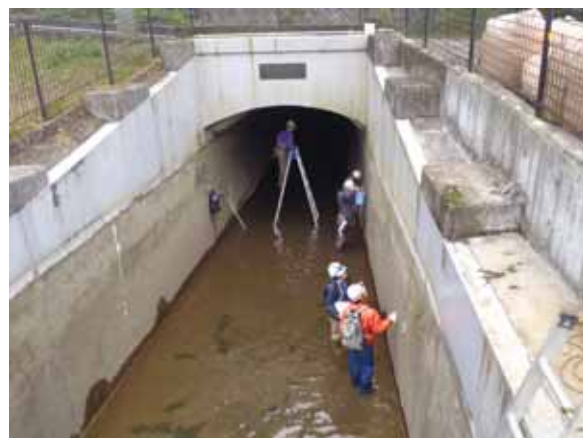
開水路内の劣化調査
