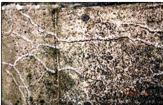
羽間開水路のひび割れ状況
