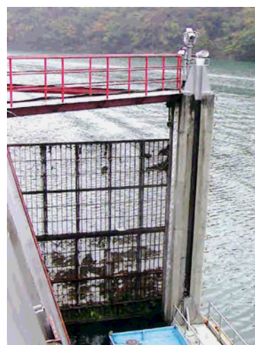
監視カメラ設置
