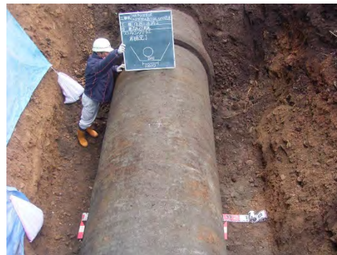
写真1.8 既設PC管の状況
