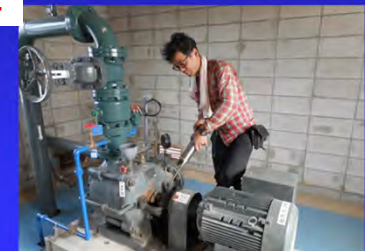
ポンプ設備の整備 (NO.18 西赤沢町地域資源保全会)
