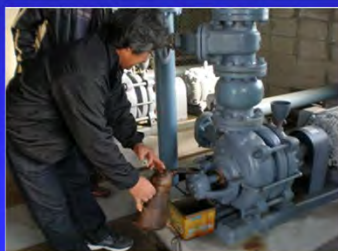
畑かんポンプのメンテナンス状況
