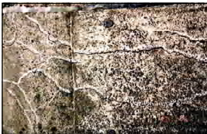
羽間開水路のひび割れ状況
