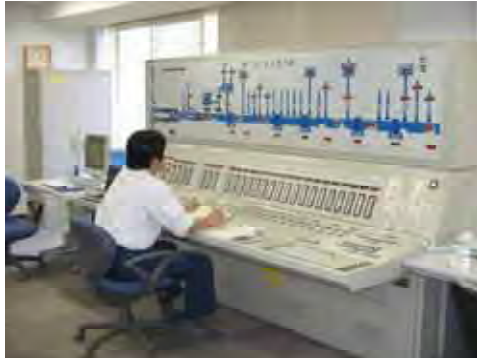
取水、配水の遠隔操作
