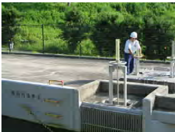
配水量に応じた分水工操作
