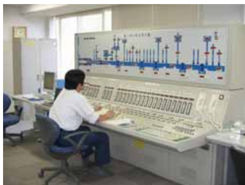
取水、配水の遠隔操作
