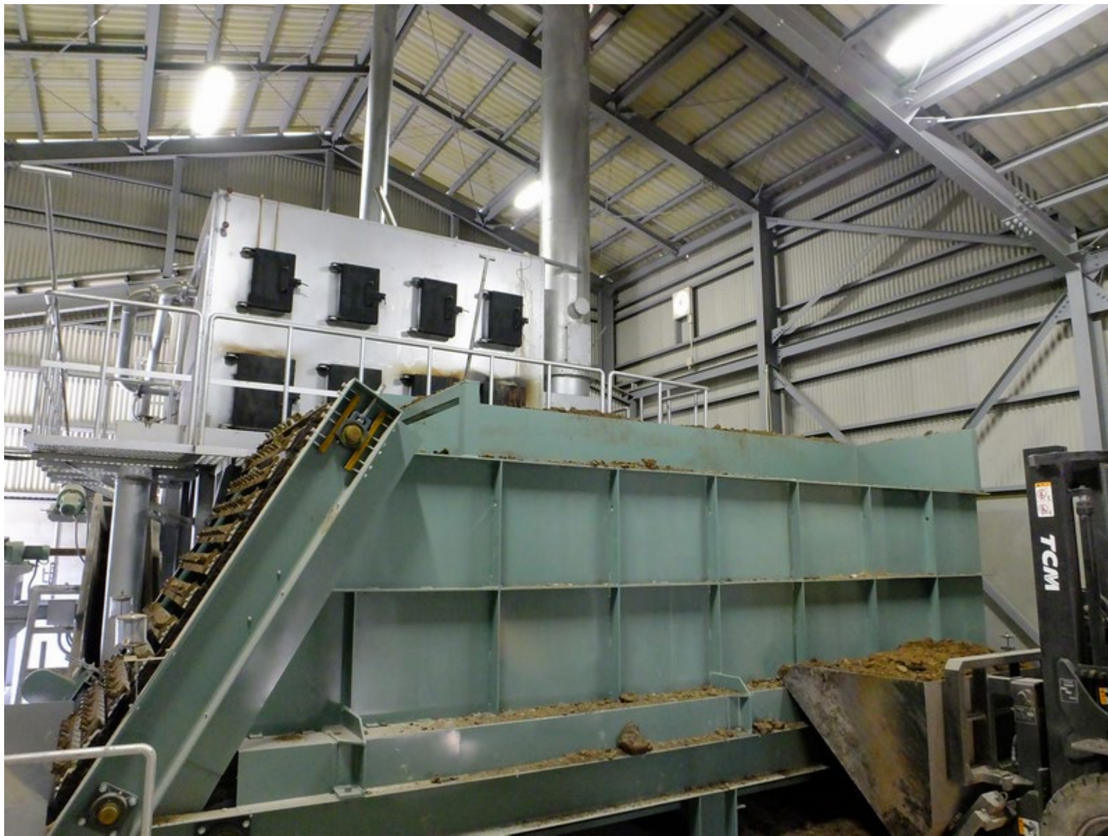
鶏糞ボイラー
