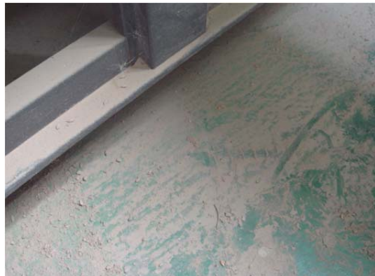
建物の床にたまったほこり
